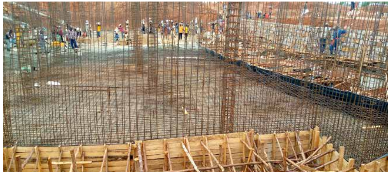
Le Centre de Conférence en construction. Les travaux doivent prendre fin en mai 2023.
