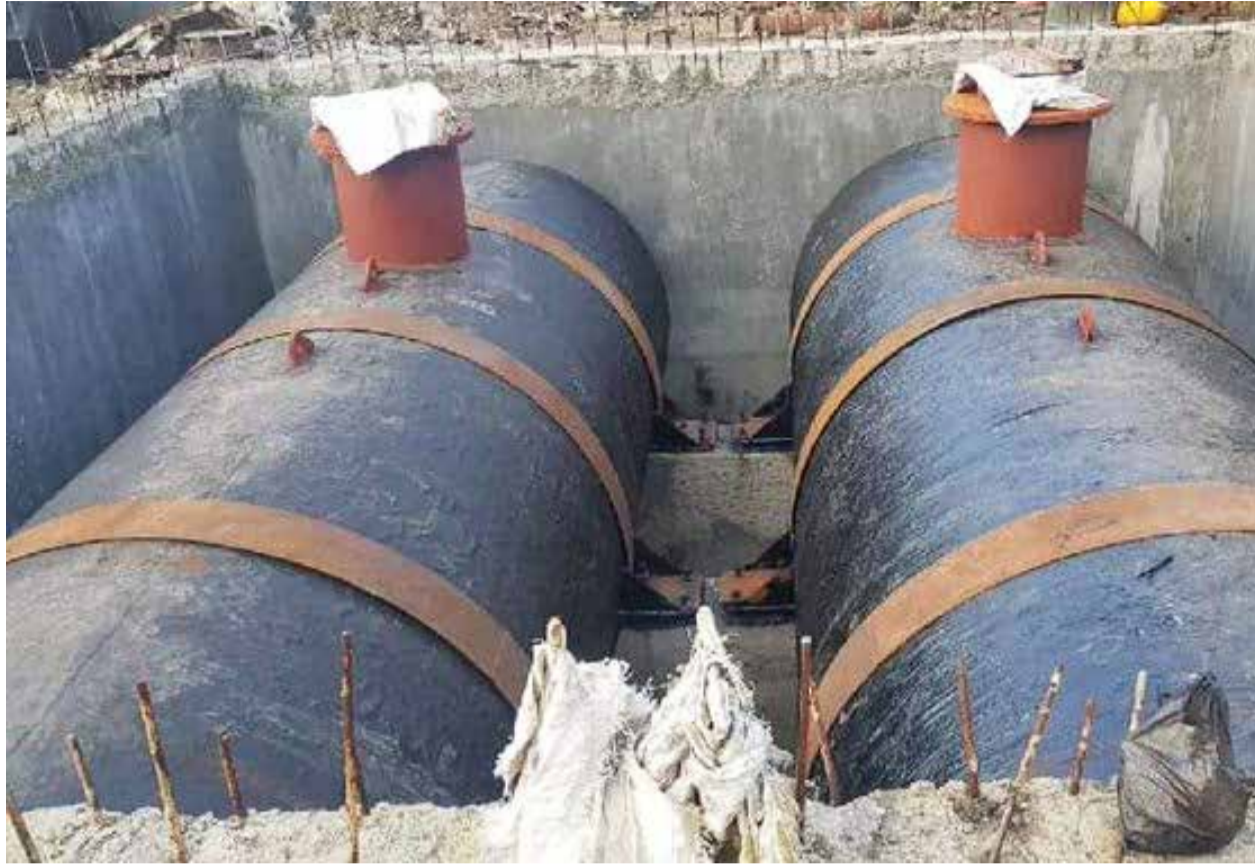
Deux personnes sont mortes asphyxiées dans la commune Gitega alors qu'ils nettoyaient une cuve souterraine d'essence d'une station-service hors d'usage pendant 5 longues années.
